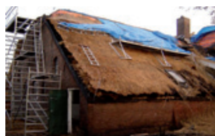
Gebouw met schroefdak na brand.
